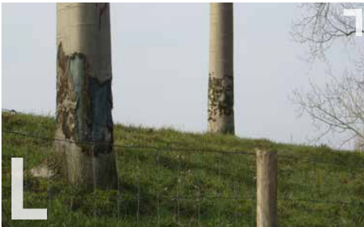
Slecht voorbeeld: vraatschade bij populieren bij ontbreken bescherming
